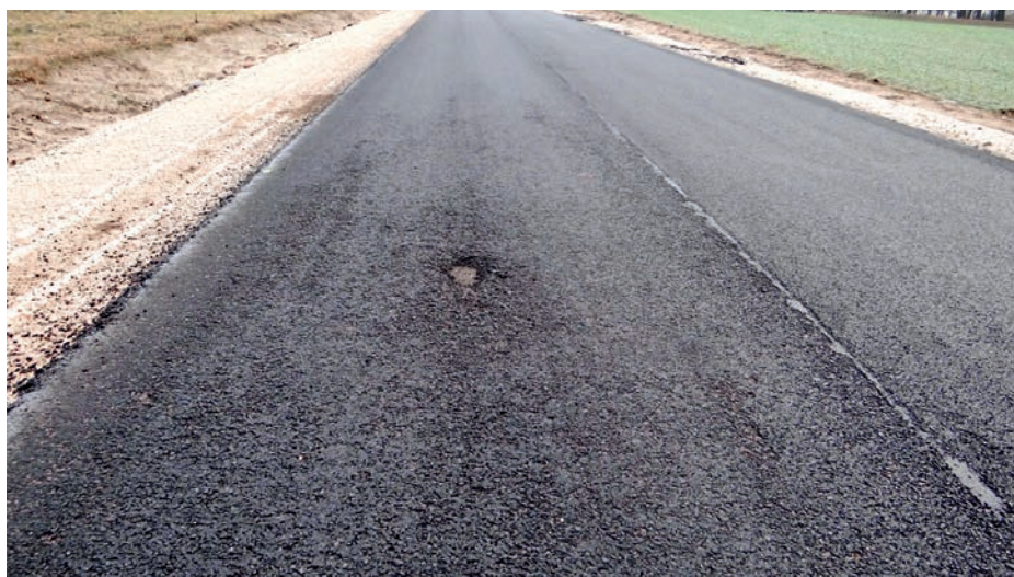
Fot. 4. Ubytki mieszanki mineralno-asfaltowej
