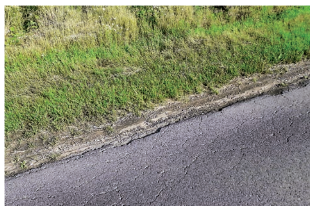
Fot. 2. Spękania krawędziowe
