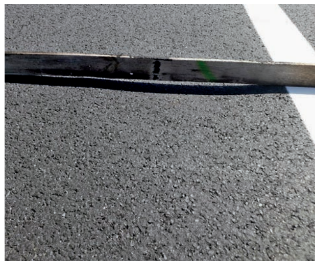
Fot. 1. Deformacja lepkoplastyczna o głębokości 22 mm
