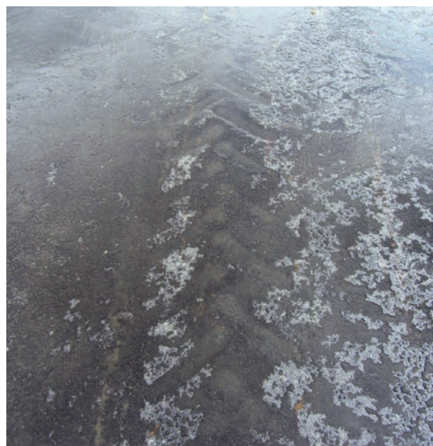
Fot. 5. Wypływy lepiszcza
